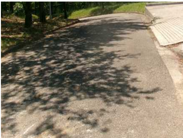
손상내용 배수지 장내 포장부 균열
