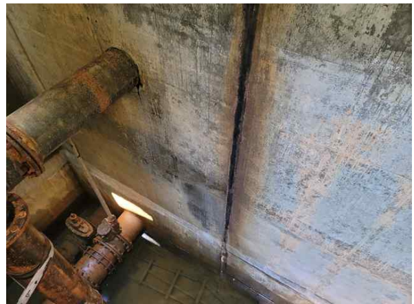
손상내용 통합유출밸브실 배면 벽체 실링재 열화 손상원인 공용중 열화
