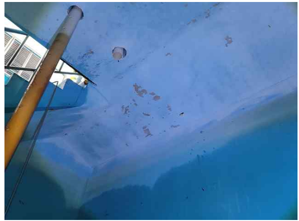
손상내용 2지 상부슬래브 도장박리 손상원인 공용중 열화
