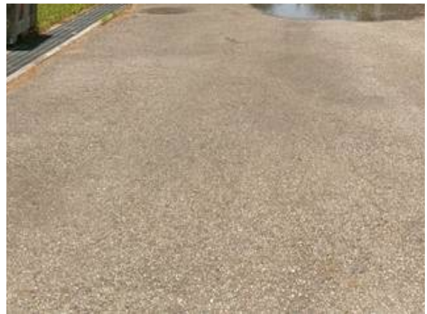
손상내용 배수지 장내 포장부 균열
