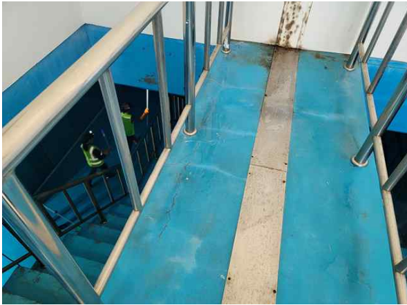
손상내용 검수실 내부 바닥슬래브 균열 손상원인 건조수축, 온도변화
