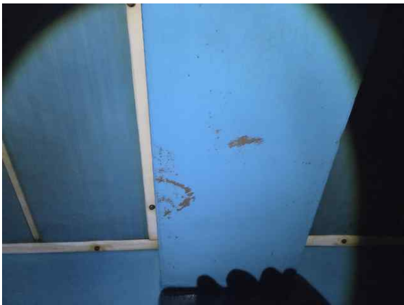
손상내용 2지 기둥 도장박리 손상원인 공용중 열화
