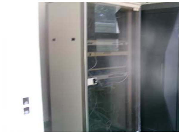
손상내용 전기실 전기설비 상태양호 손상원인 -
