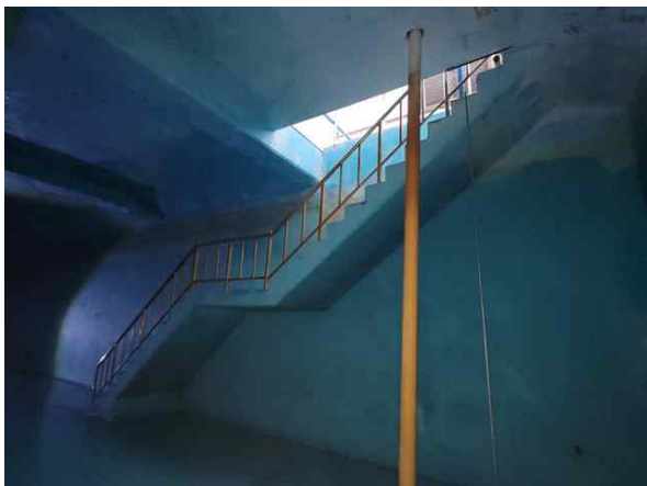
배수지 계단 안전난간 현황
