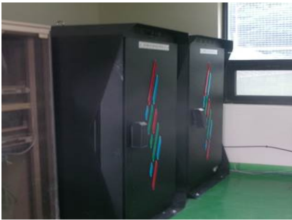
손상내용 전기실 전기설비 상태양호 손상원인 -
