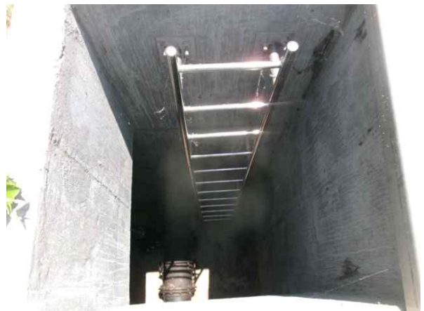
유입밸브실 사다리 현황
