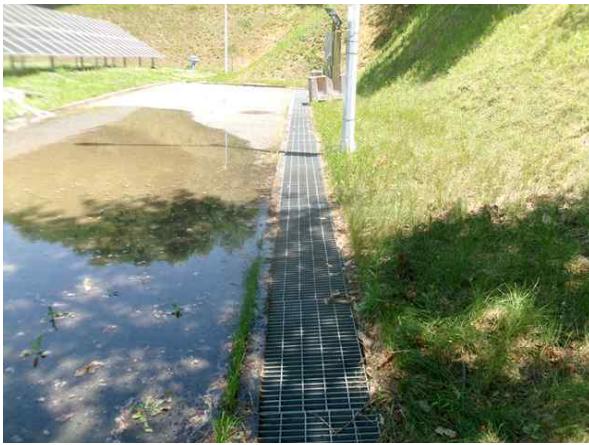
손상내용 배수로 상태현황
