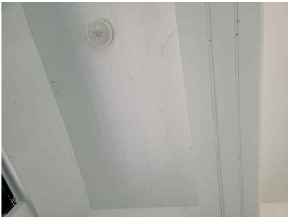
손상내용 검수실 내부 상부슬래브 도장박리 손상원인 도장미흡, 공용기간 증가
