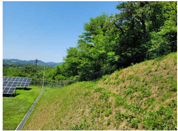
손상내용 사면(성토부) 상태현황
