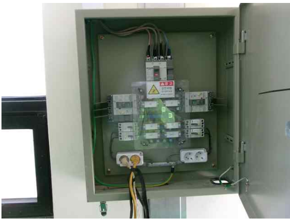
손상내용 전기실 전력 배전반 상태양호 손상원인 -
