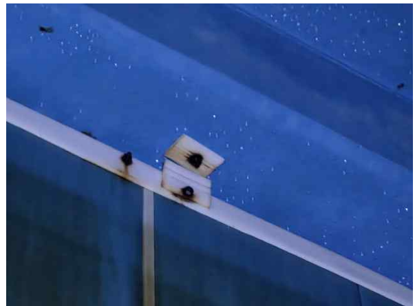
손상내용 2지 도류벽 브라켓 파손 손상원인 공용기간 증가
