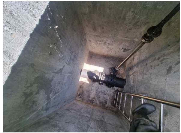
손상내용 유입밸브실 2지 상태양호 손상원인 -
