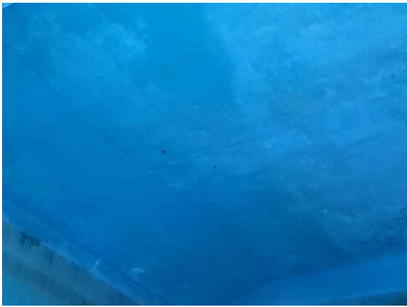
손상내용 2지 상부슬래브 녹물 손상원인 피복두께 부족
