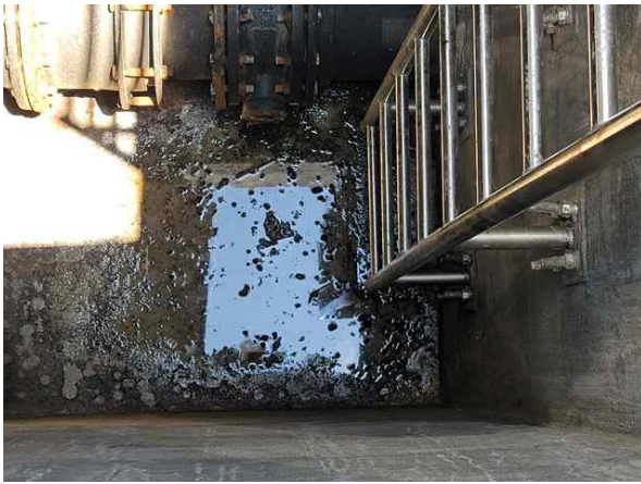
손상내용 유입밸브실 1지 바닥슬래브 चे수 손상원인 외부 우수유입
