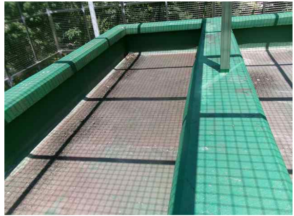
손상내용 검수실 외부 옥상 채수흔적 손상원인 배수구 막힘
