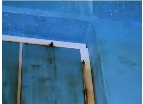
손상내용 2지 도류벽 볼트부식 손상원인 공용중 열화
