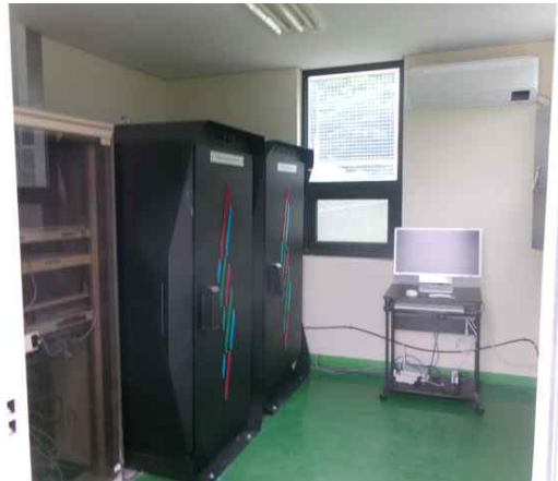
전기실 내부 전경
